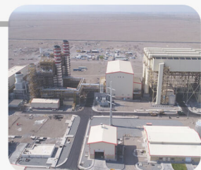
پروژه نیروگاه سیکل ترکیبی سمنگان سیرجان
